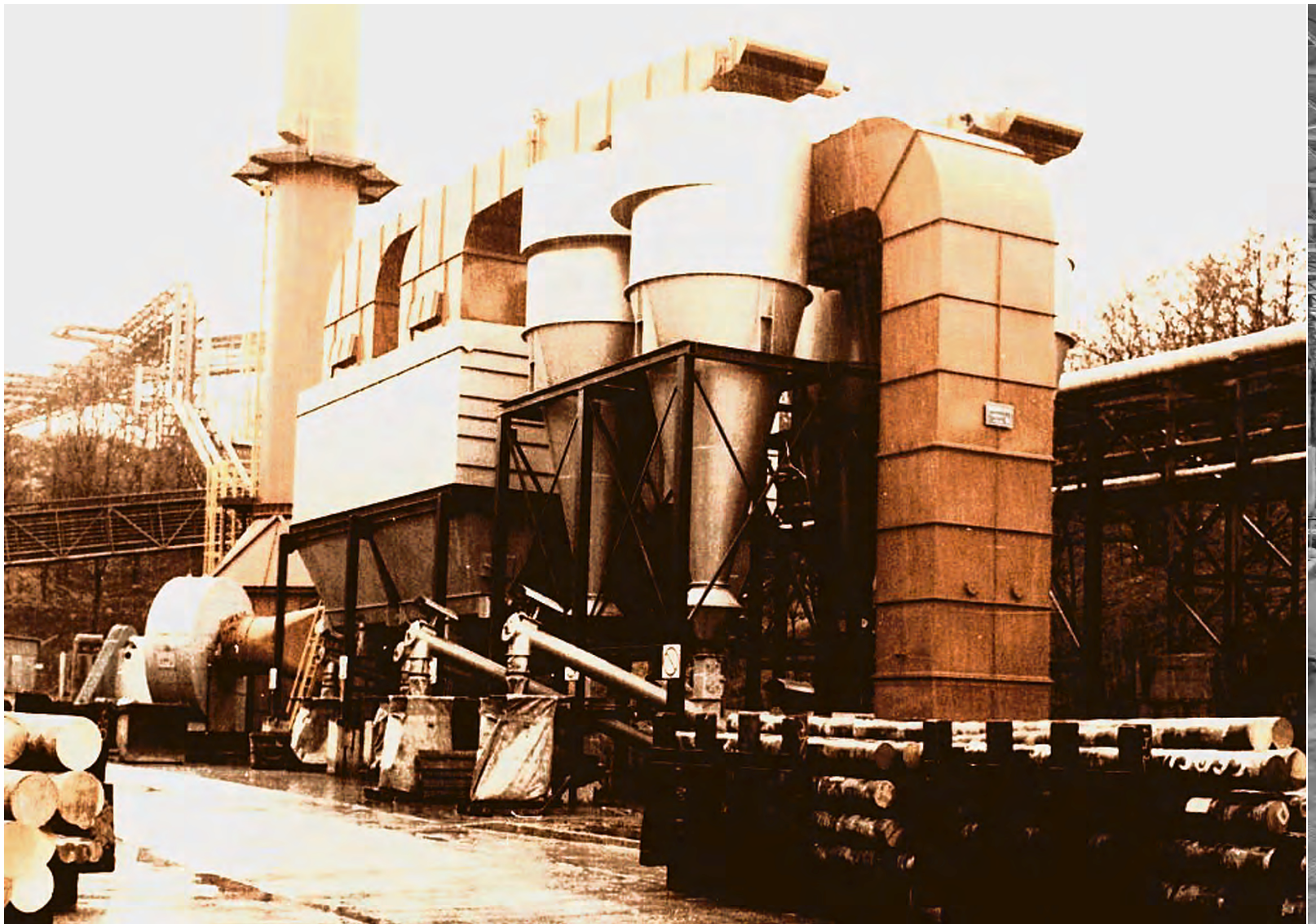
Hochwirksame Abgas-Textilfilter-Anlage SM-Schwermetallgießerei
